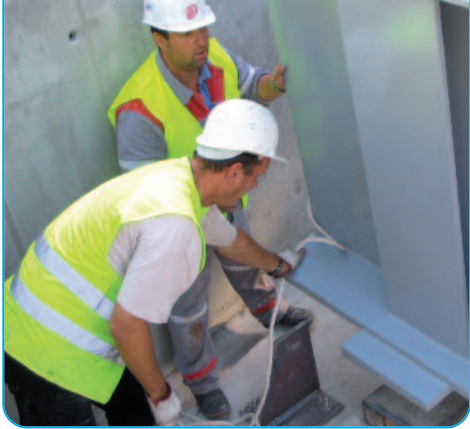
Pose de la charpente métallique du demi tablier du pont traversant le canal du Réal
