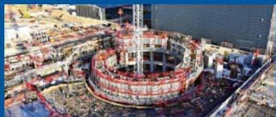
16 mars 2017. Le puits de 30 mètres de diamètre s'élève. Il accueillera le tokamak. L'assemblage de cette machine débutera en 2018.
