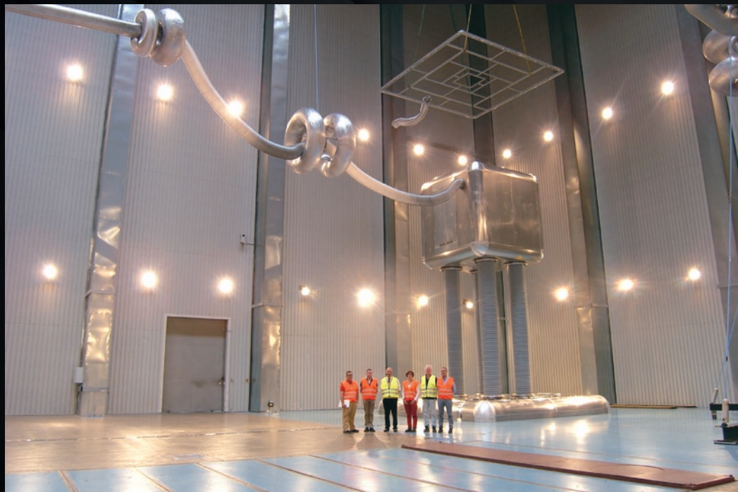
À six mètres au-dessus du sol, la maquette au 1/15e d'un dispositif haute tension destiné à l'installation MITICA vient d'être testée par la société allemande HSP GmbH. MITICA est un banc-test en cours de construction au Neutral Beam Test Facility de Padoue, en Italie.
