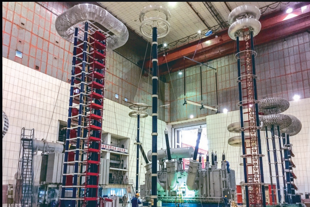
Destinés au réseau électrique pulsé, les trois transformateurs-abaisseurs (300 MVA, 460 tonnes, 15 mètres de haut) que fournit la Chine ont passé avec succès les tests de réception en usine. Le premier d'entre eux sera livré au mois de septembre 2016.
