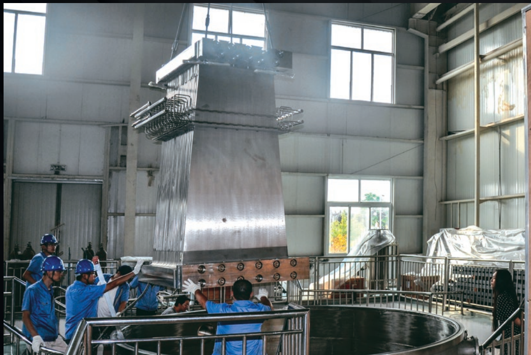
Chacun des 18 aimants de champ toroïdal (verticaux) reposera sur un piédestal de ce type ( gravity support ), activement refroidi à l'hélium liquide et boulonné à la base du cryostat. Celui-ci s'apprête à subir un test d'étanchéité en Chine avant d'être livré à ITER.
