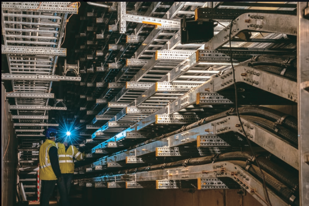
Près de 10 000 kilomètres de câbles serpentent dans les galeries souterraines de l'installation. C'est la distance qui sépare le sud de la France de la côte du Pérou.
