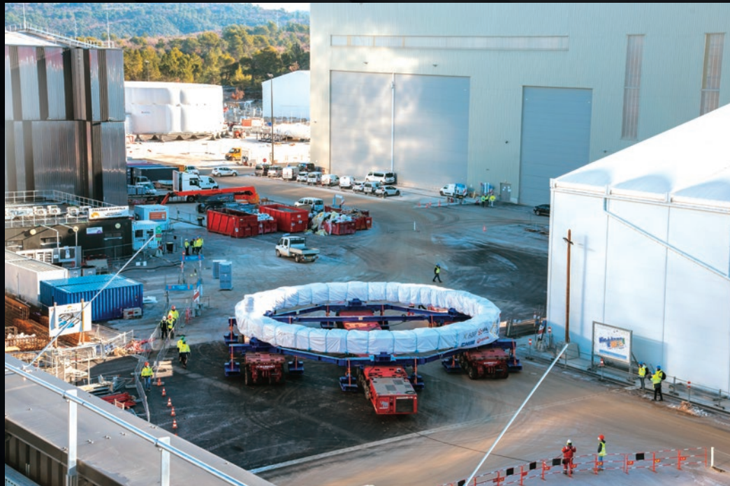
En 2021, l'Europe a finalisé sur site une deuxième bobine de champ poloidal (PF2). Cette bobine annulaire de 17 mètres de diamètre sera stockée dans l'attente de son installation.
