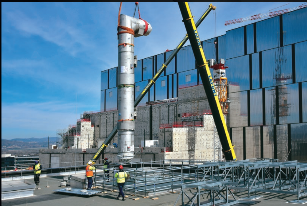
Cet élément de ligne cryogénique fait partie du réseau qui transporte les fluides de refroidissement de l'usine cryogénique au Bâtiment tokamak.
