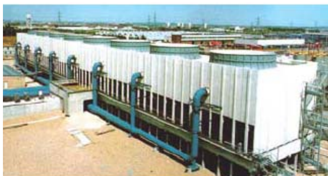
Figure 13 : tours de refroidissement à tirage forcé
