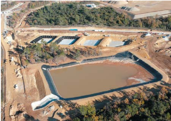
Bassin d'orage de collecte des eaux de ruissellement provenant de la plate-forme ITER, du poste électrique et de la zone végétalisée située en dessous de la plate-forme (au premier plan) et bassins de contrôle des eaux de refroidissement.
