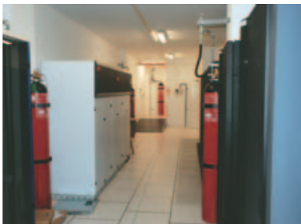
Système d'extinction dans les locaux du siège ITER.
