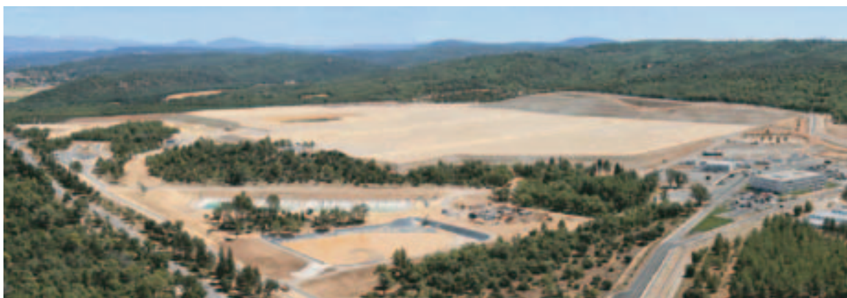
Travaux de terrassement sur le site, avec au premier plan, le bassin d'orage. Ce bassin d'une capacité de 19 000 m 3 est dimensionné pour une pluie décennale (débit de fuite de 0,6 m 3 /s) évacuée via une canalisation d'un diamètre de 800 mm. Une déverse permet d'assurer l'évacuation d'une pluie centennale.
