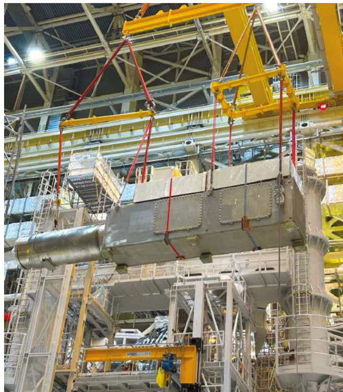
▲ Un élément de la ligne d'alimentation du système magnétique passe au-dessus des têtes dans le Hall d'assemblage. Appelé « boîte de terminaison », il s'agit du dernier composant de ce système à être installé dans les galeries du bâtiment tokamak.
