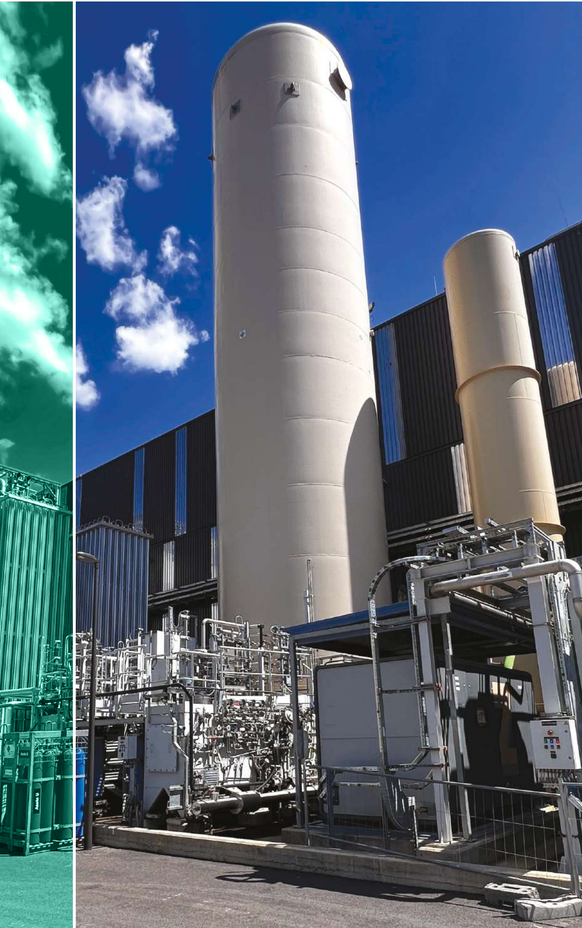
▲ Vue extérieure de l'usine cryogénique d'ITER avec le réservoir d'azote liquide qui domine l'installation.
