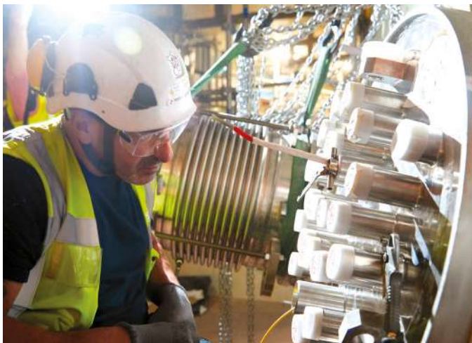
▲ Seize gyrotrons ont été livrés à ce jour à ITER, huit par le Japon et huit par la Russie. Ce gyrotron japonais sera le premier des 24 qui seront installés au niveau 3 du bâtiment radiofréquence et mis en service.
